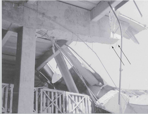
Falla debida al cortante.
