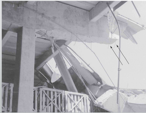
Falla debida al cortante.
