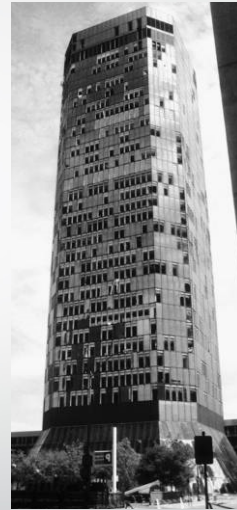
Ruptura de vidrios en fachada debido a un tornado. (Edificio Bank One en Texas)
