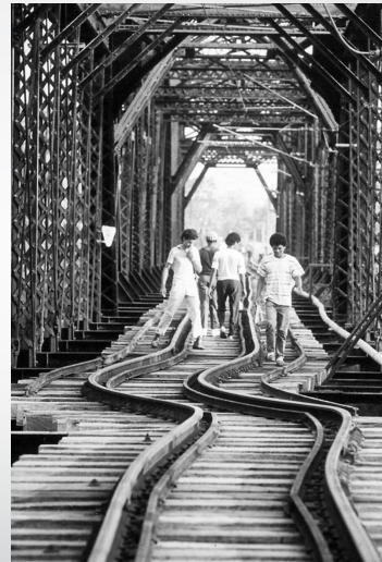
Daño en puente metálico y en la vía férrea. Terremoto de Limón, 22 de abril, 1991.
